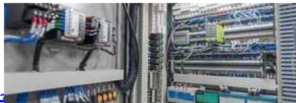
تجهیزات تابلو برق صنعتی
